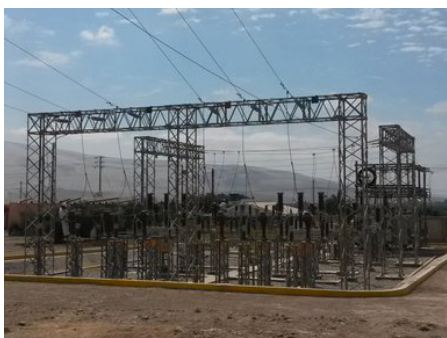
Subestación eléctrica Bella Unión, en la región Arequipa
